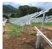
岩手県滝沢市 0.7MW
