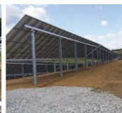
群馬県山田町 2.4MW
